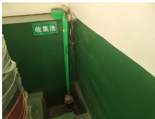
收集池及提升泵
