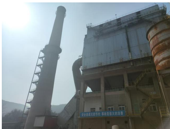
布袋除尘器+排气筒
