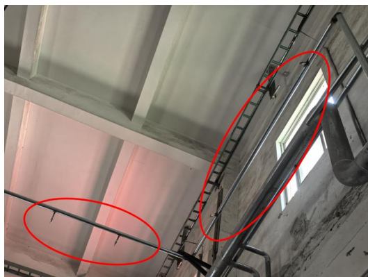
除尘喷雾设备
