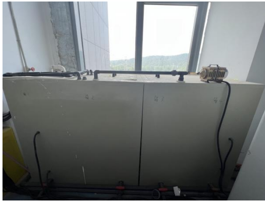
污水处理设施（碱中和+絮凝沉淀+厌氧/好氧+消毒+两级生物吸附系统+管式超滤系统）
