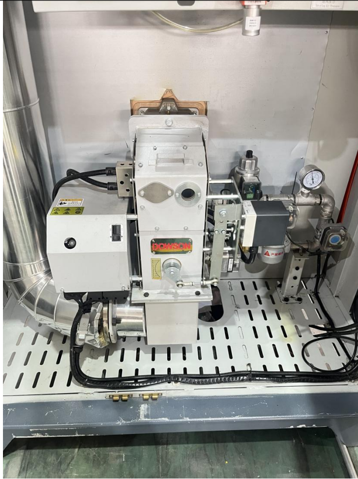
图 3.1-3 废气处理设施标牌、低氮燃烧器
