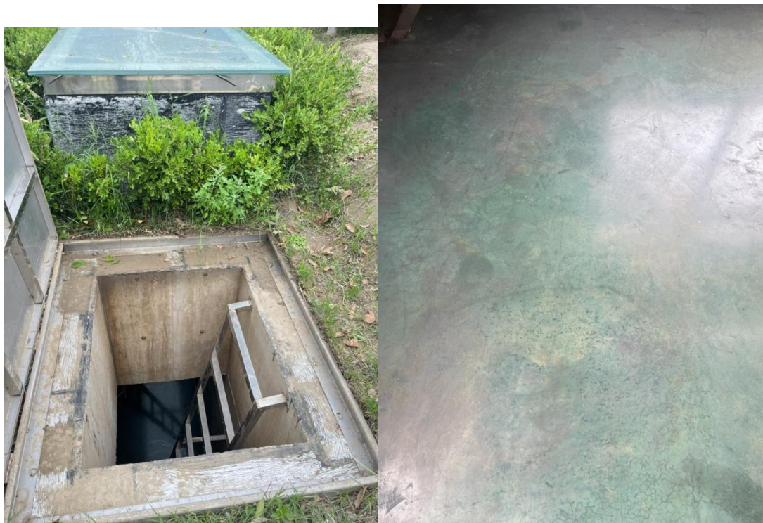
图 3-5 应急事故池、地面防渗
