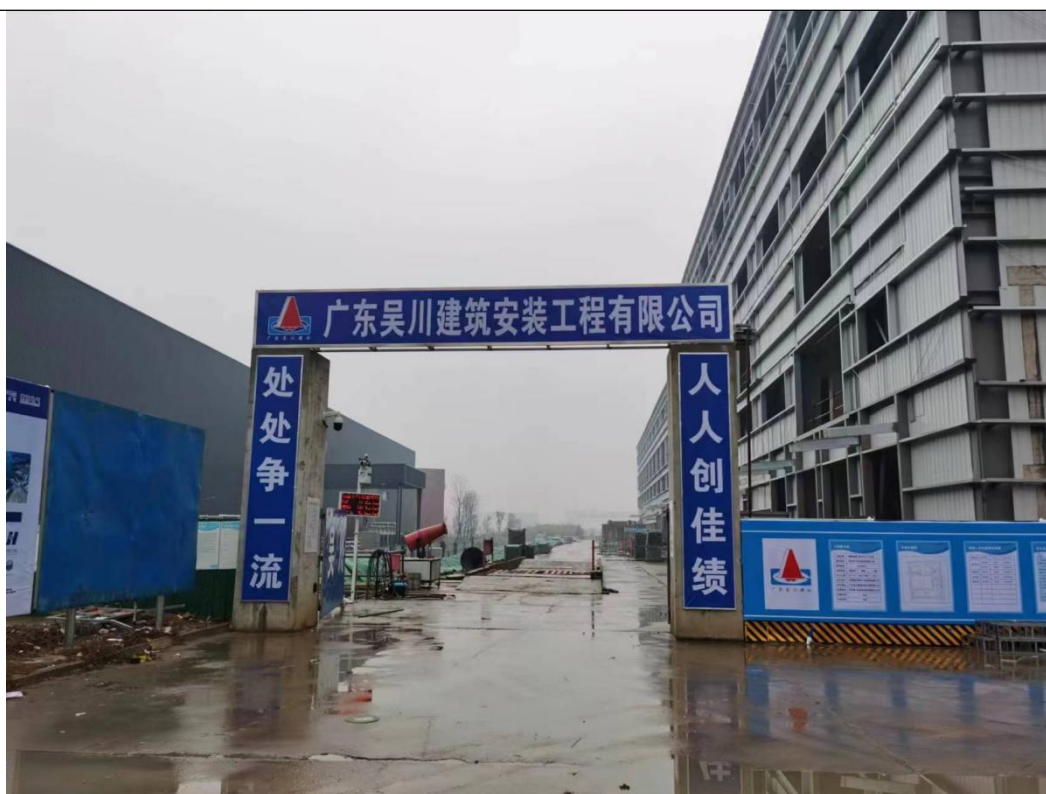
车辆冲洗设施处设置排水和泥浆沉淀设施
