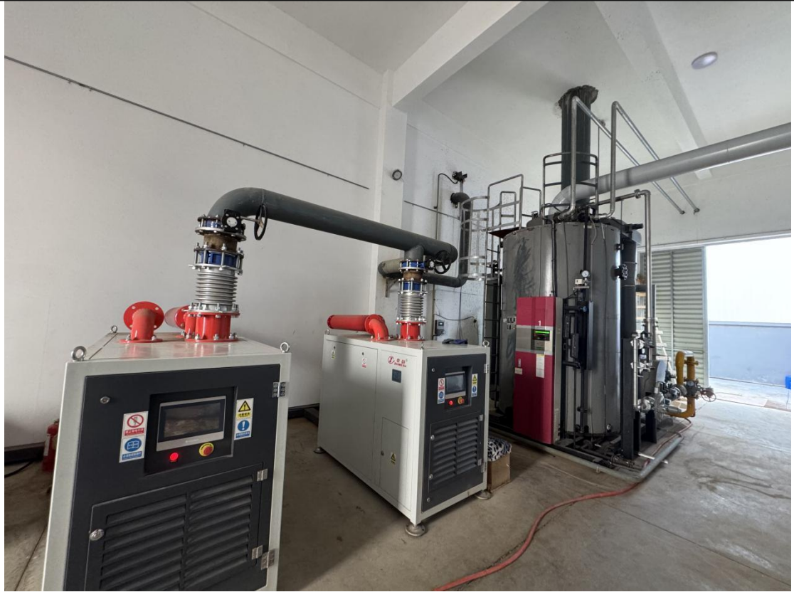
图 4 燃气锅炉现状照片
