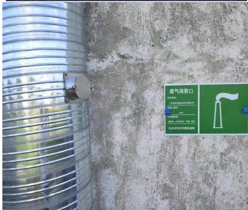
图 3.1-3 废气处理设施
