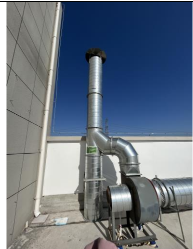
DA002 废气处理装置及排气筒
