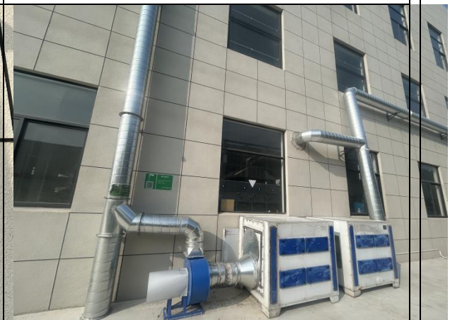
DA003 废气处理装置及排气筒
