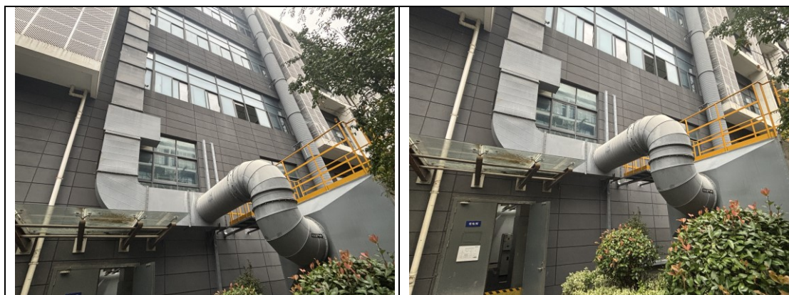
图 6-1 废气处理设施进口处
