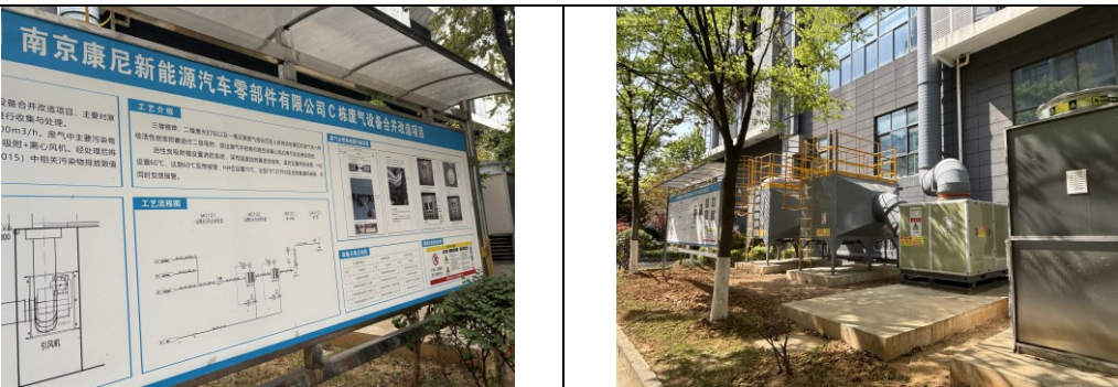
图 3-2 废气处理设施现场照片
