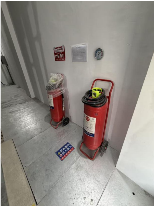
图 6-3 站内消防设施
