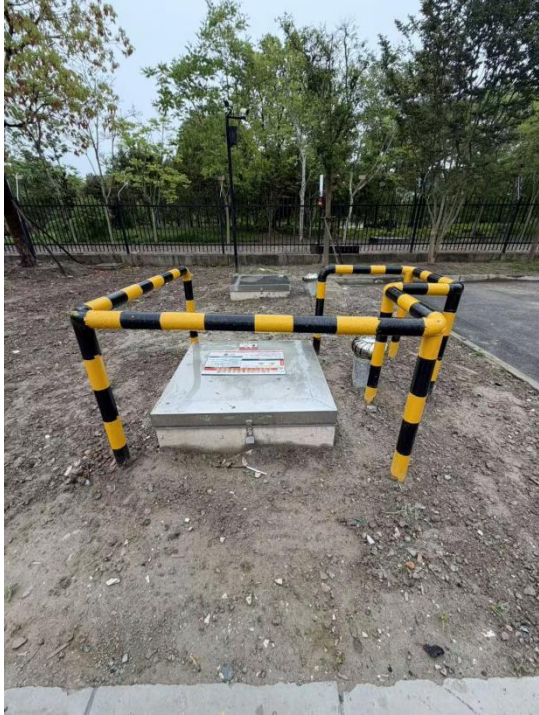
图 6-1 事故油池照片
