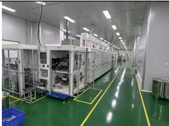
管道密闭收集
