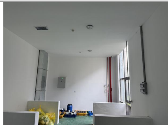
危废暂存间负压收集
