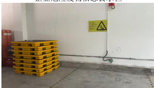
危废库内部标志牌及防渗托盘
