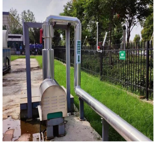
事故应急池及初期雨水池
