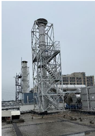
DA007 排气筒及采样平台
