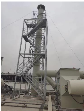
DA001 排气筒及采样平台
