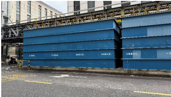
厂区污水处理站
