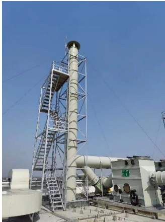
DA003 排气筒及采样平台
