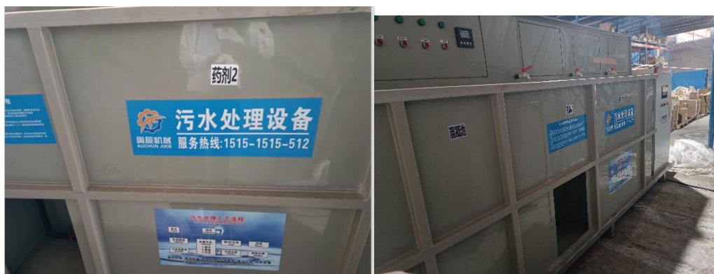
图3-2 污水站处理现场照片
