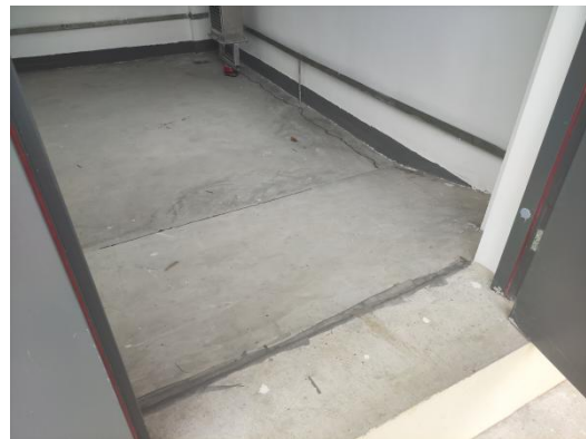
危化品贮存地面重点防渗
