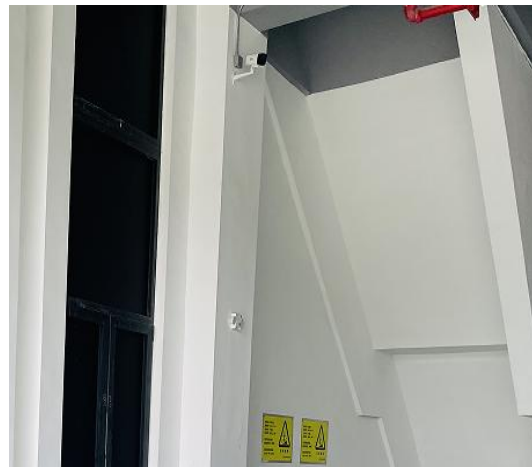
危废仓库内监控
