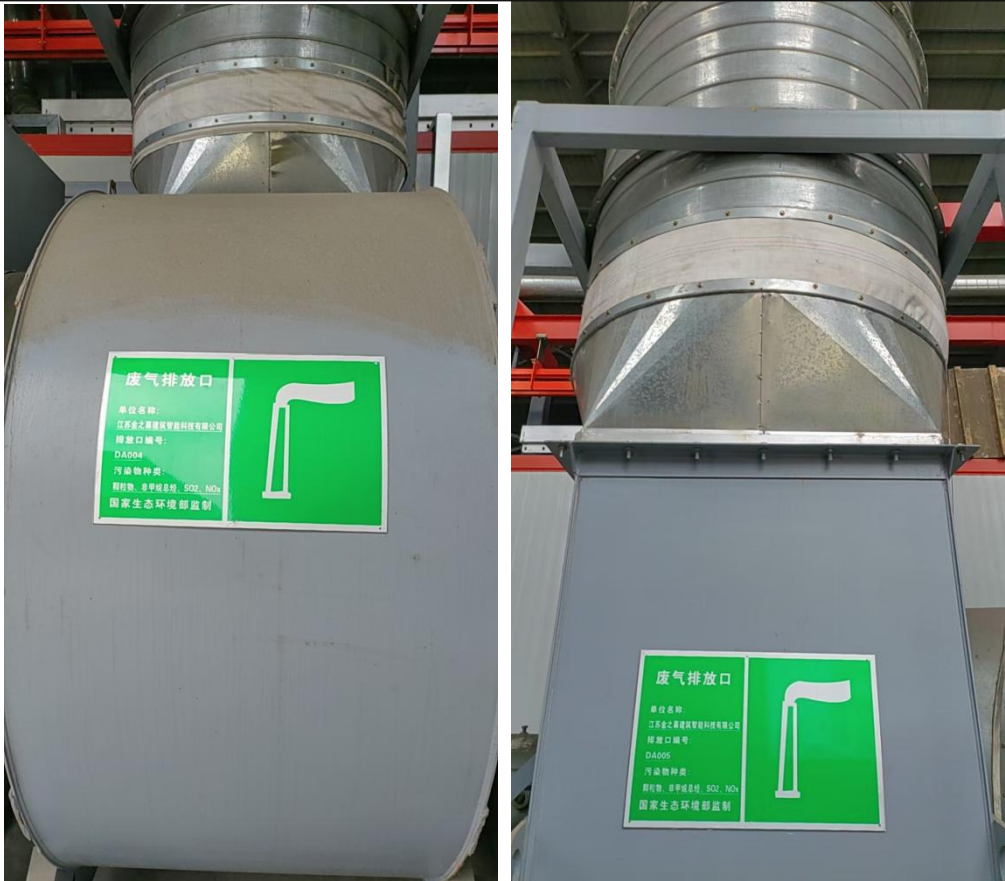
图 3.1-3 废气处理设施标牌
