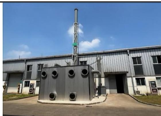
生物滴滤（16#排气筒）
