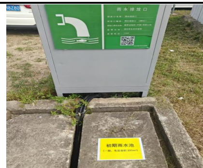
一期雨水排口
