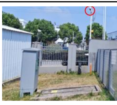
雨水排口视频监控
