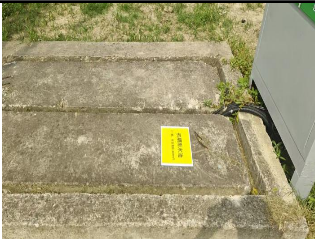
一期区域初期雨水池照片
