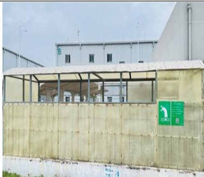
污水排口标识牌
