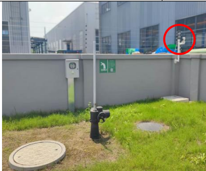
二期雨水排口、标识牌、视频监控
