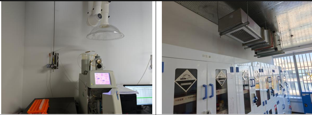
实验室、试剂间废气收集装置
