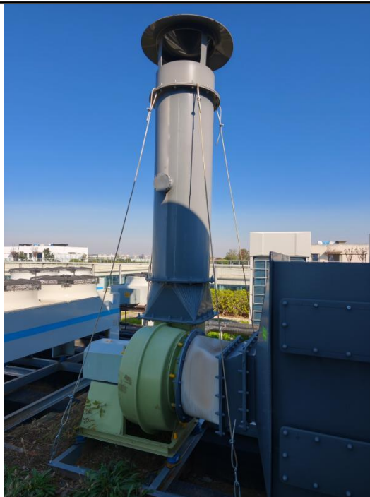
DA002 排气筒标识牌
