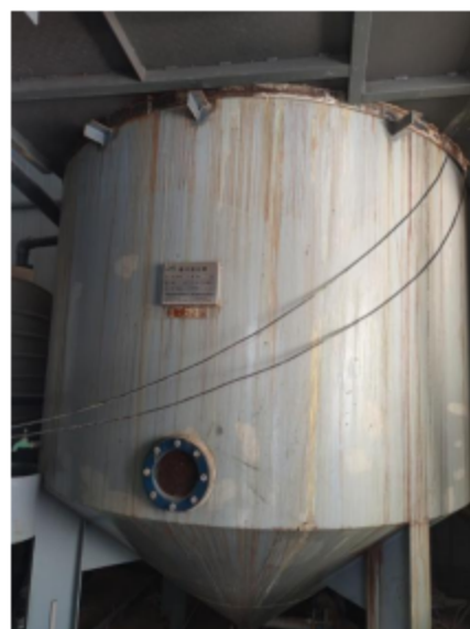
综合废水处理系统
