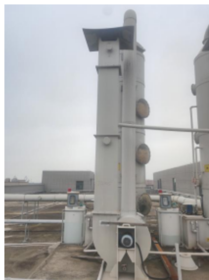
DA005排气筒及碱洗塔装置
