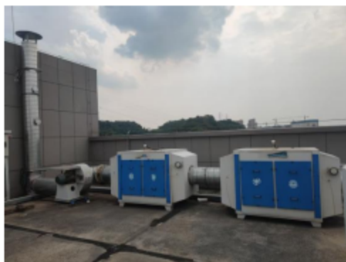
DA003排气筒及二级活性炭装置
