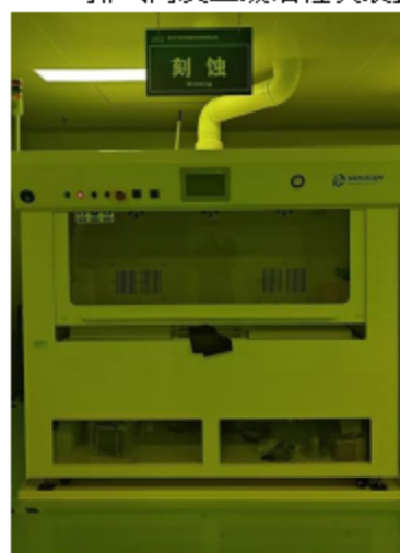
刻蚀工艺废气收集
