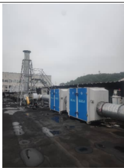
DA002排气筒及二级活性炭装置
