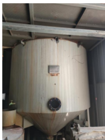
含铬废水处理系统
