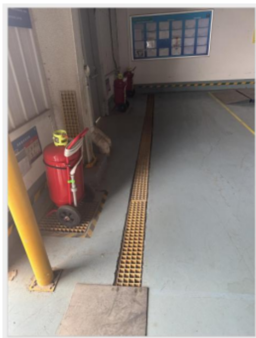
危废仓库收集槽
