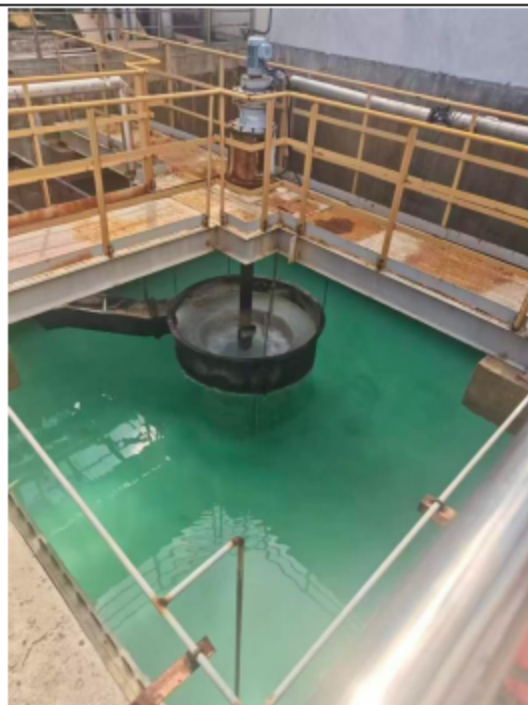
含氟废水处理系统加药沉淀池
