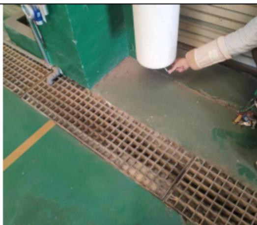
危废仓库集液沟
