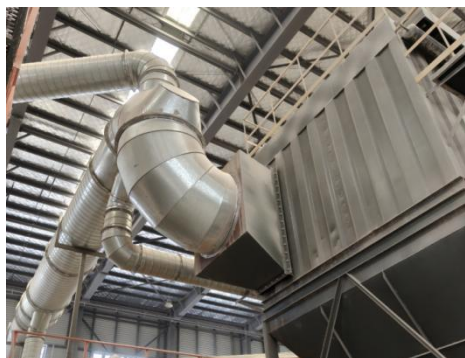
DA001 布袋除尘器进口管道照片
