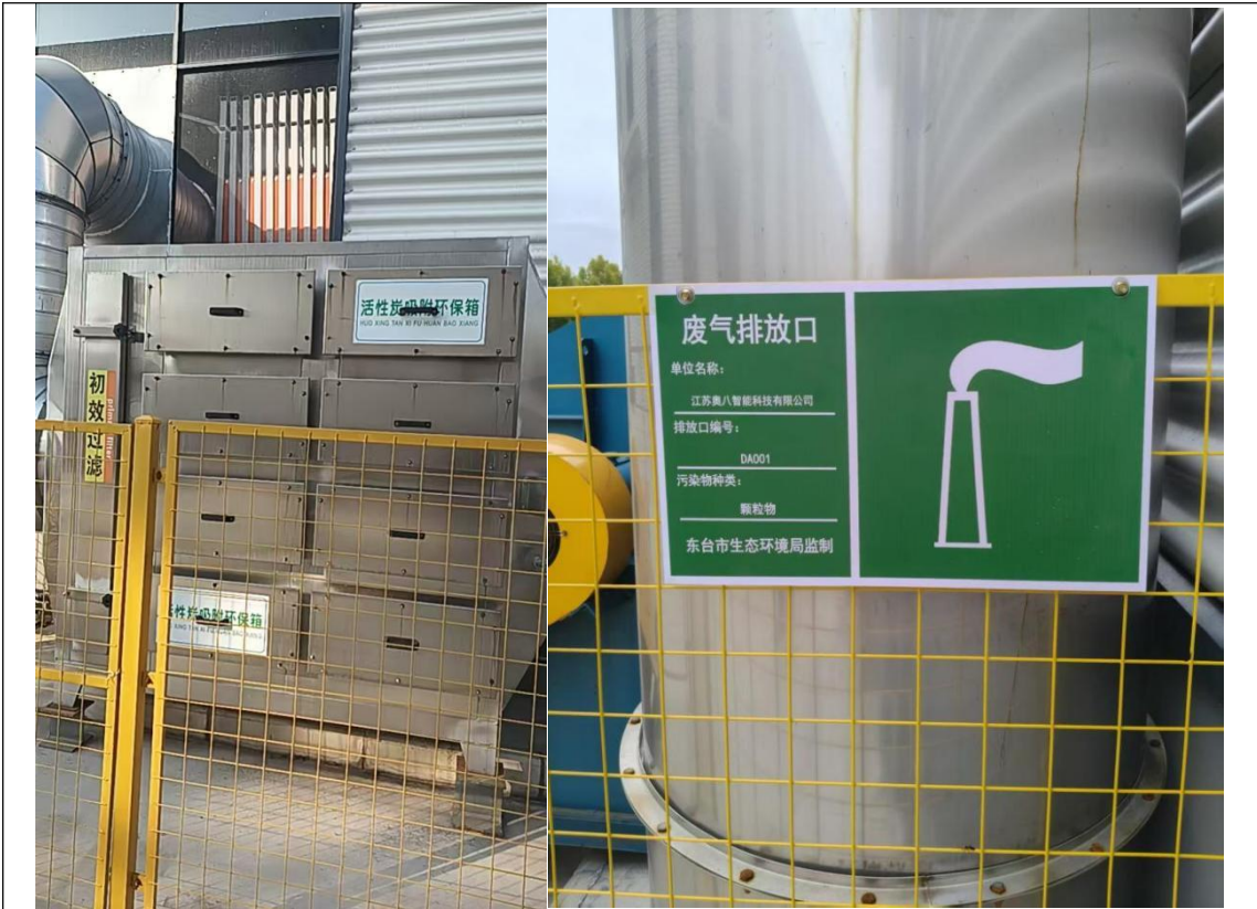
图 3.1-3 废气处理设施
