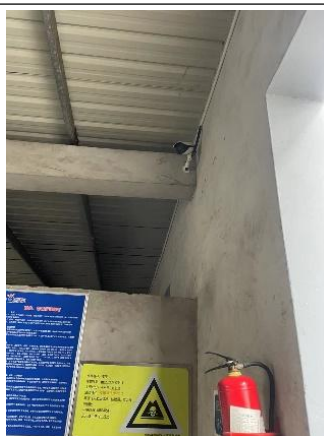
危废贮存点监控
